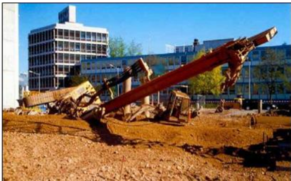
Abbildung 2 bei Bohrarbeiten 5-Zenter-Bombe angebohrt
